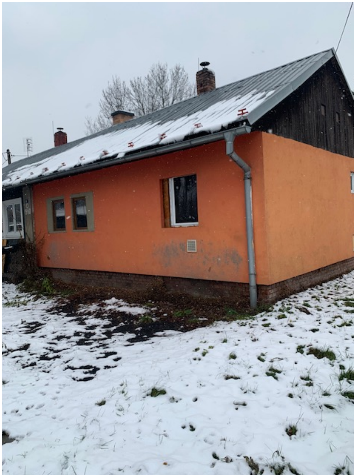
Pohled od ulice včetně nedopracovaných detailů kolem oken
